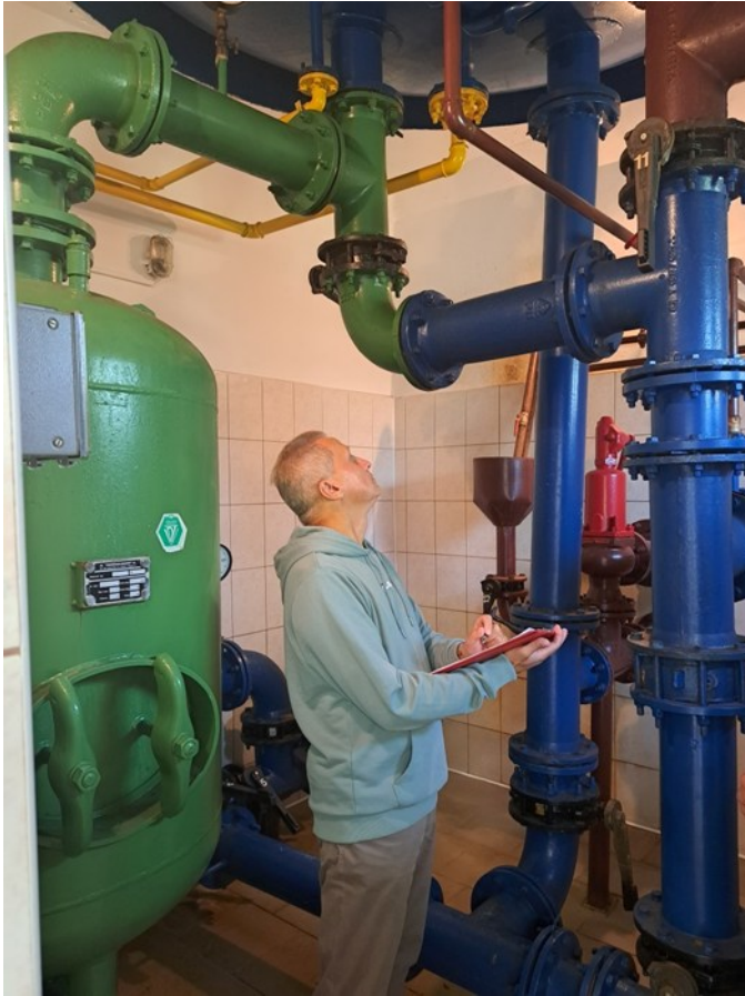
Zdjęcie 2 - kontrola stacji uzdatniania wody (zdjęcie własne).
